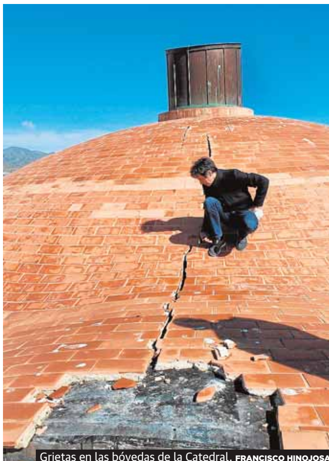
Grietas en las bóvedas de la Catedral. FRANCISCO HINOJOSA
